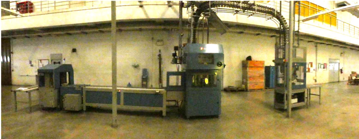
รายการที่ 3 เครื่องจักรระบบเมลล์รูม (Mail Room System)
