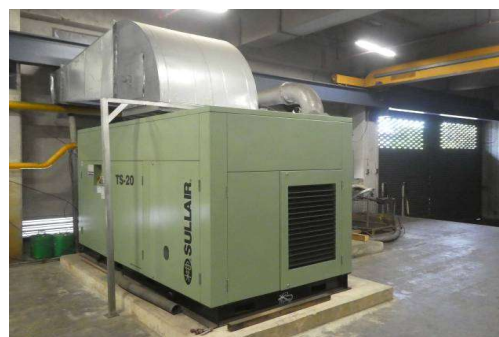
รายการที่ 7 เครื่องจักรระบบลมอัด (Air Compressor System)
